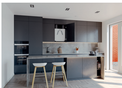
EASE 200 installé dans un placard de cuisine
